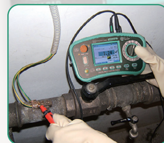
Continuity check of equipotential bonding
